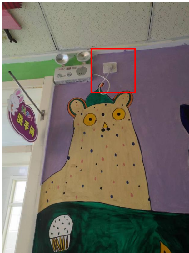
应急照明灯未按要求整改取消插头
